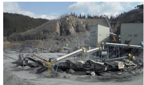
写真1 ロコトレインシステム稼働状況
