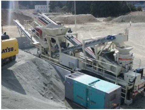
写真6 NW100HP設置状況
