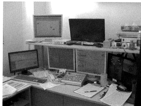
更新したばかりの計量制御盤
