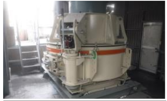
図9 BM7150SE 納入設置写真
