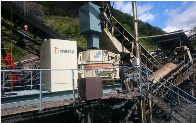
図8 BM7150SE 納入設置写真
