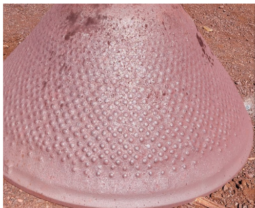
図3 MX ライナー使用後（取り外した状況）
