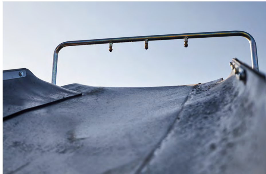
ポンプ付き散水システムで効率的な粉塵抑制。
